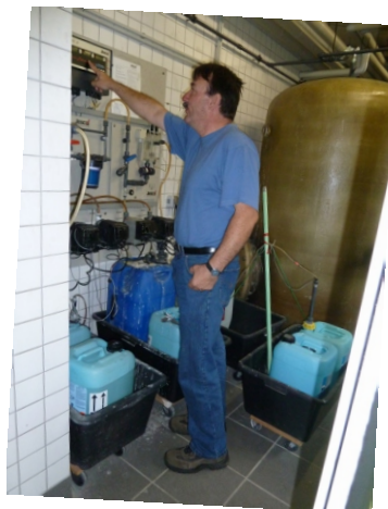
Die Technik im Schwimmbad.
