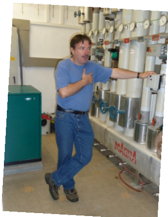
Herr Thomas erklärt uns die Heizung.
